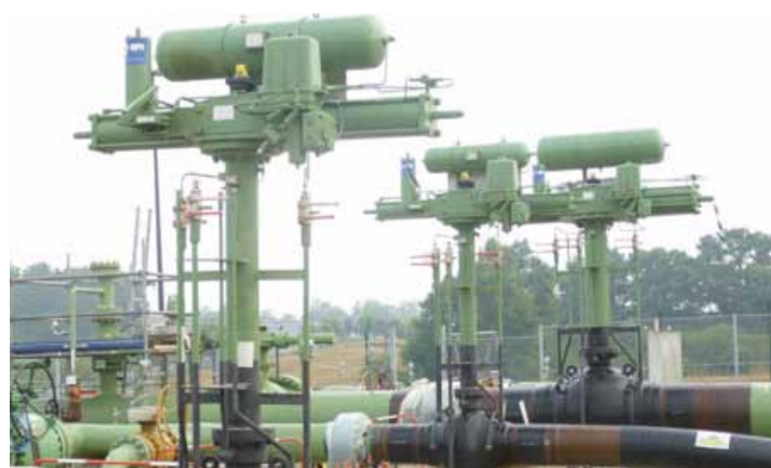
Vannes de sécurité dites ESDV
