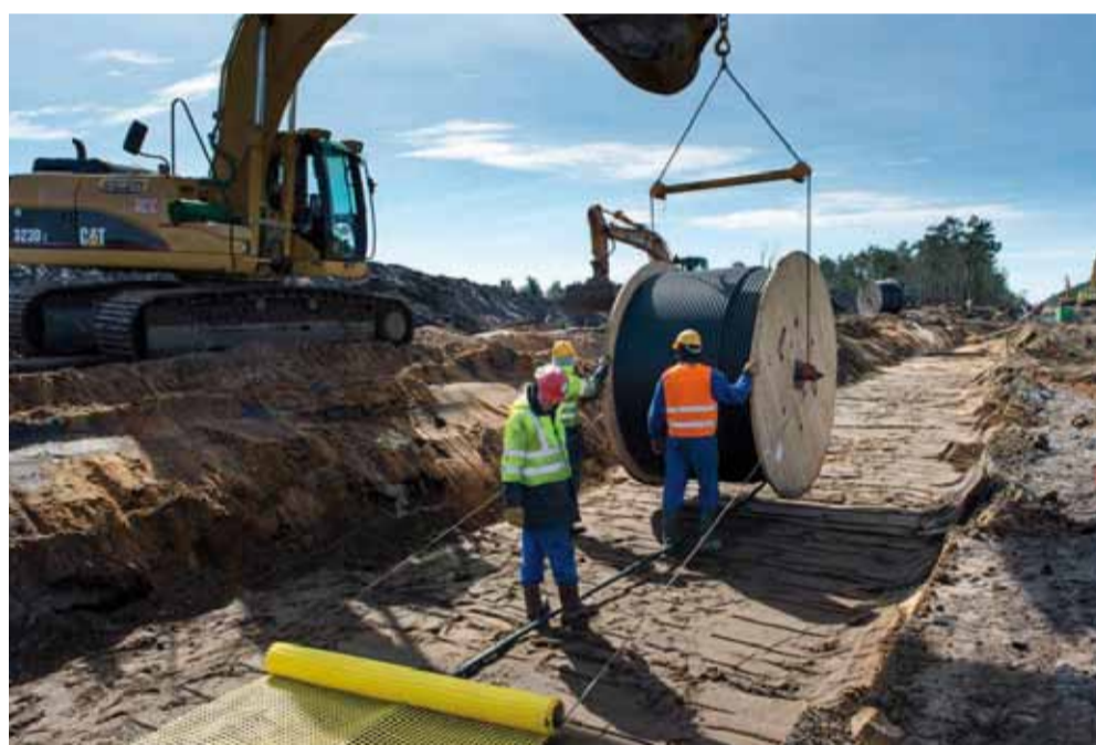
Mise en place de la fibre optique et du grillage avertisseur avant remblaiement
